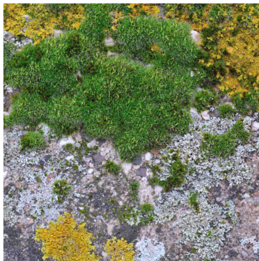
beton begroeid met mos en korstmos
